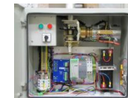
Шкаф с электродвигателем
